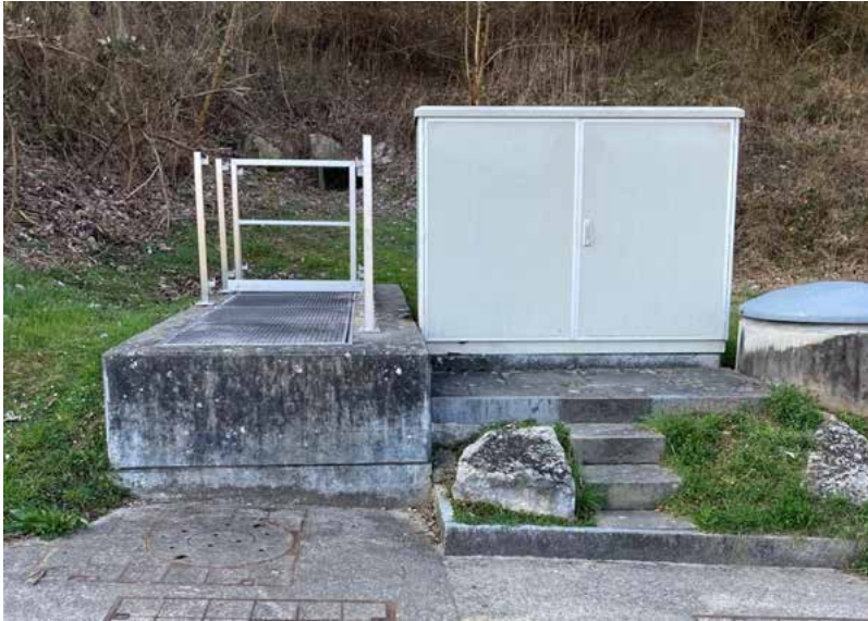
Pumpwerk Chaibegrabe, Leuggern
